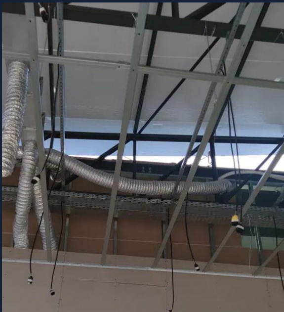
Infraestrutura da loja dutos de climatização · forro técnico · elétrica embutida
